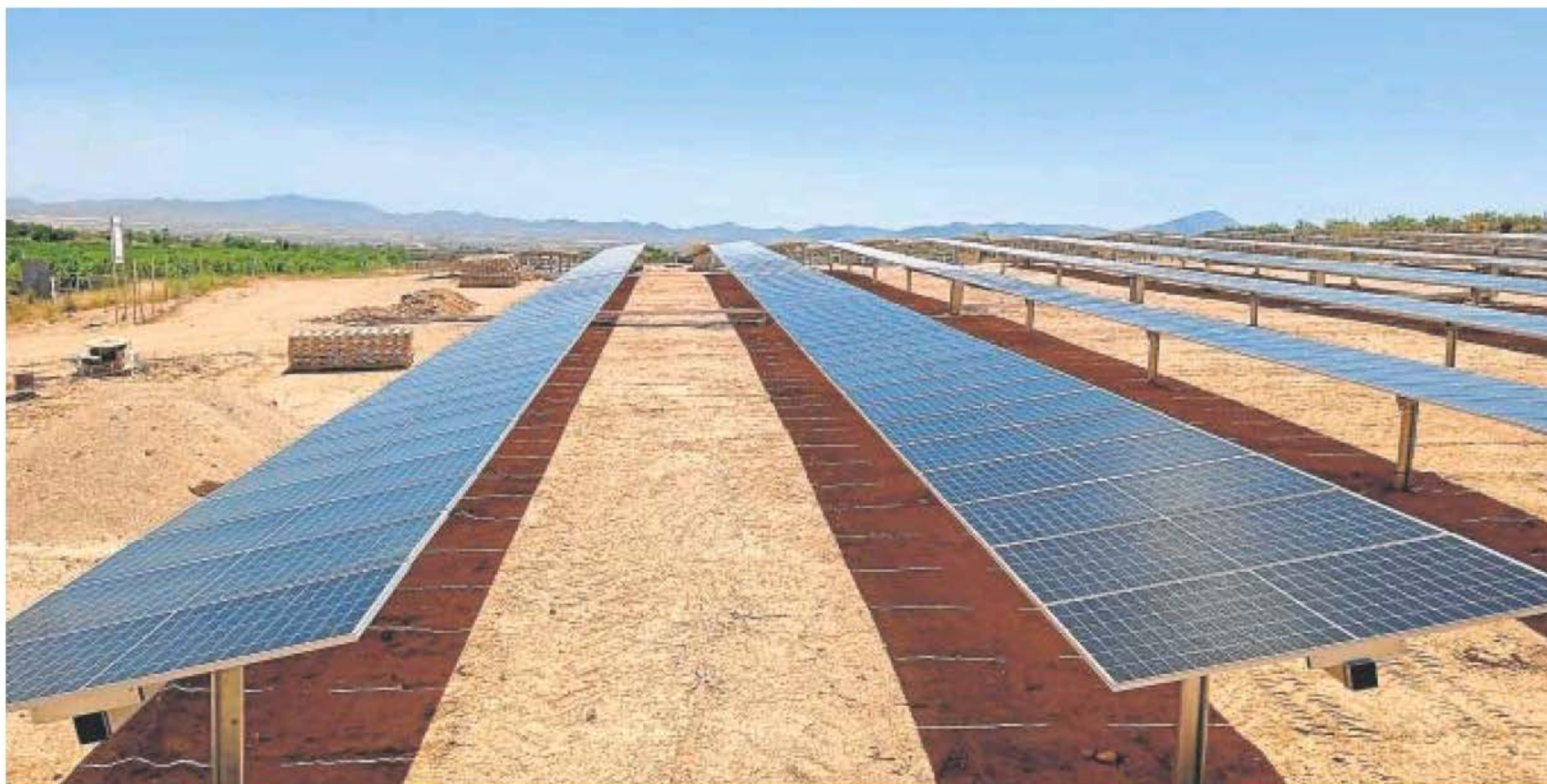
Una imagen de las instalaciones que Comunidad Solar tiene en el Megapark de Fuente Álamo, en la región de Murcia
