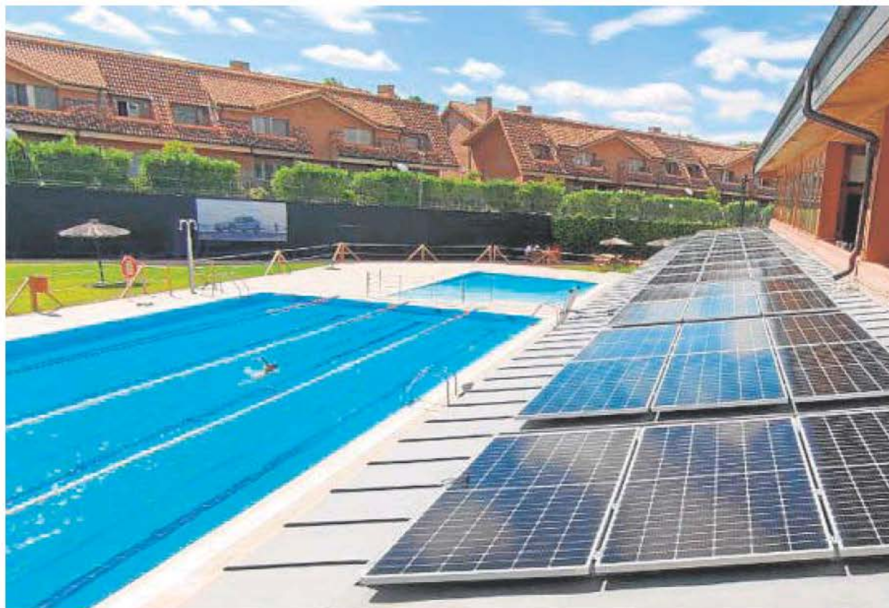
Una de las instalaciones de autoconsumo de Capital Energy en Madrid // CAPITAL ENERGY
